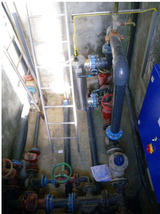
Traitement dans la chambre de vannes du réservoir de Bas-Quet
